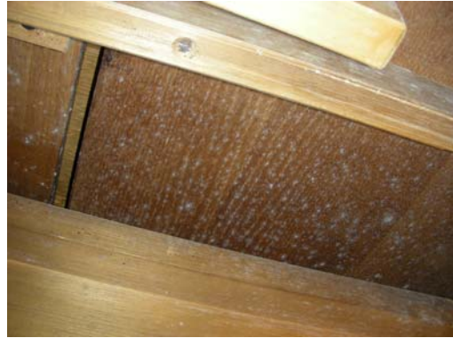
Moisissures sous une table en bois
