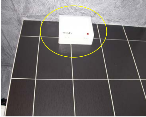
Extracteur électrique dans une salle de bains
