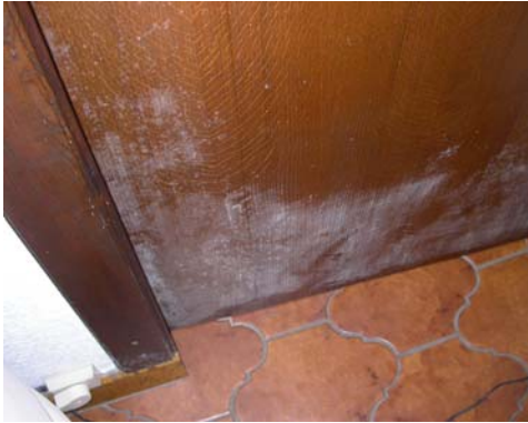
Moisissures au bas d'une porte
