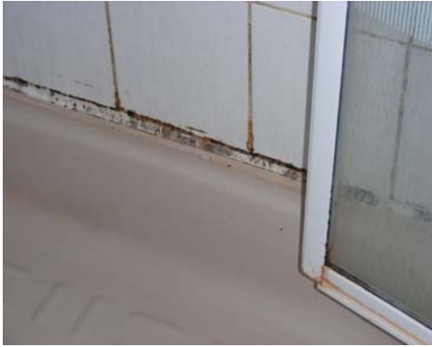
Moisissures dans les joints d'une cabine de douches
