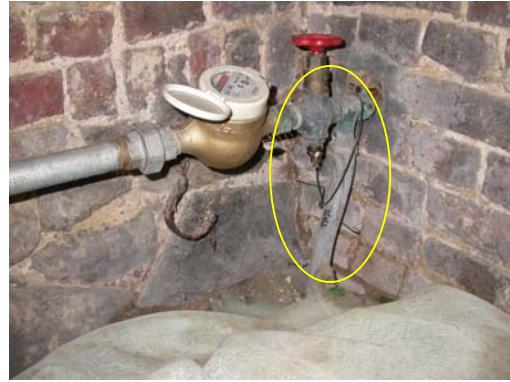
Arrivée d'eau en plomb avant le compteur
