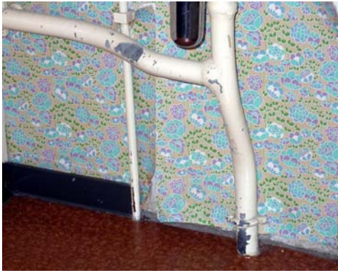
Tuyauteries en plomb dans la crèche
