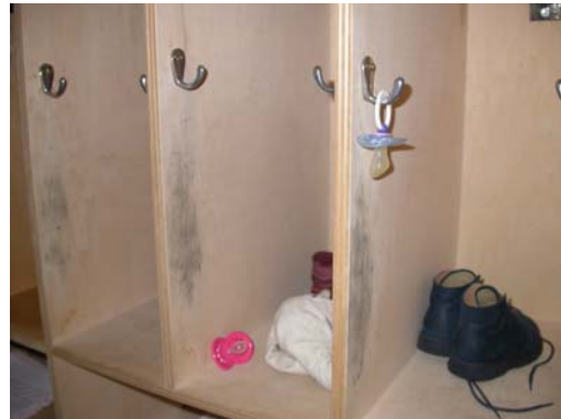
Développement de moisissures dans des casiers d'enfants
