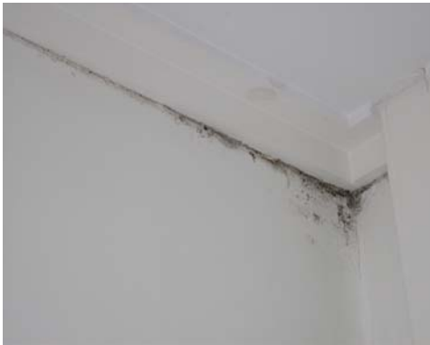
Moisissures à l'angle entre le mur et le plafond
