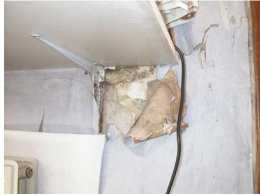
Moisissures derrière du papier peint
