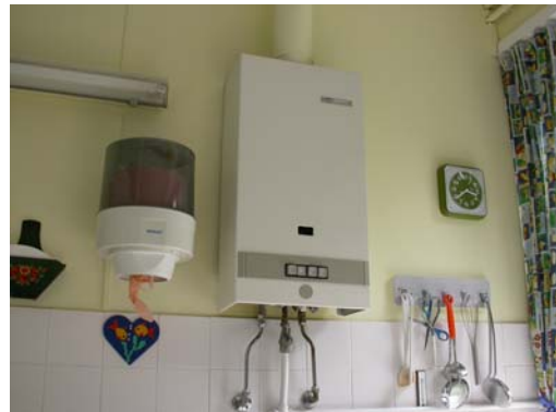
Chauffe-eau au gaz juste avant le robinet
