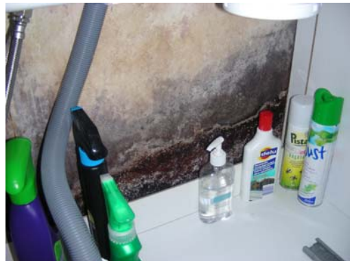
Moisissures derrière une cuisine équipée
