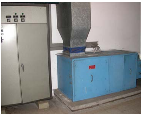
Ancien système de climatisation
