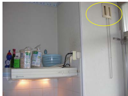
Extracteur d'air dans un mur
