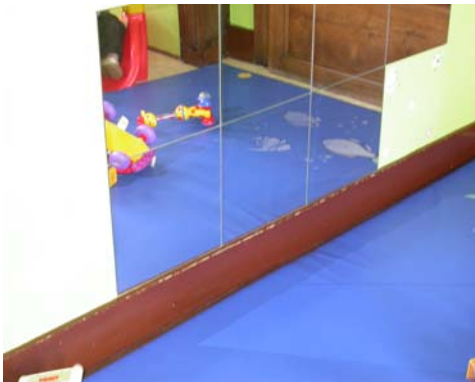
Plinthe en bois avec peinture au plomb dans une salle de jeux d'enfant
